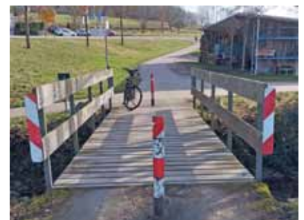
Es gibt noch zu tun im Kandertal. Zum Beispiel bei dieser Brücke in Höhe Wollbach, wo Pfosten ungeschickt und gefährlich im Weg stehen.
